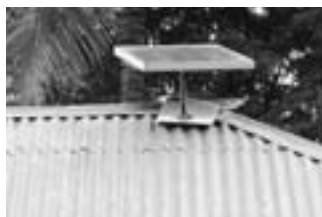
屋根に設置された太陽光パネル
